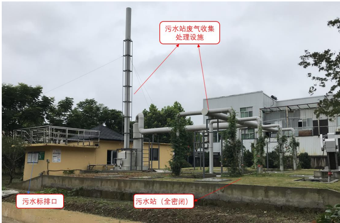
图4.1.1-3 污水站及其废气收集处理设施照片
